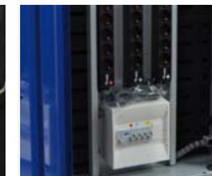
Diferencial e disjuntores de proteção Diferencial e interruptores magnetotérmicos
