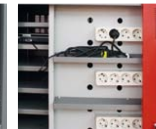
Armazenamento de transformadores Almacenamiento adaptadores AC
